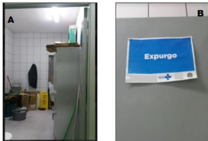
Figuras 18-A e 18-B - Sala de expurgo sem a identificação “ Abrigo Temporário de Resíduo”
