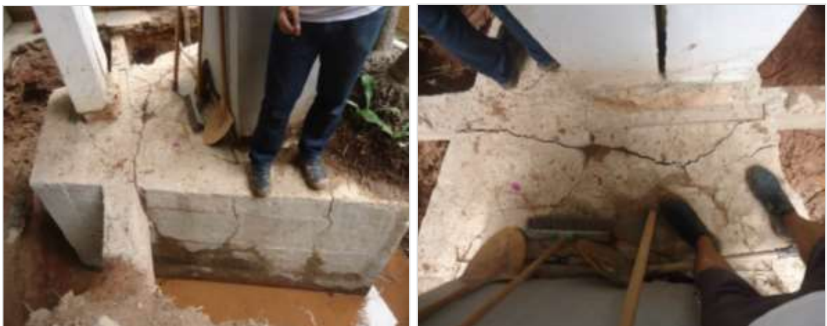
Figura 2: Vista geral dos blocos de fundação com presença de fissuras.
