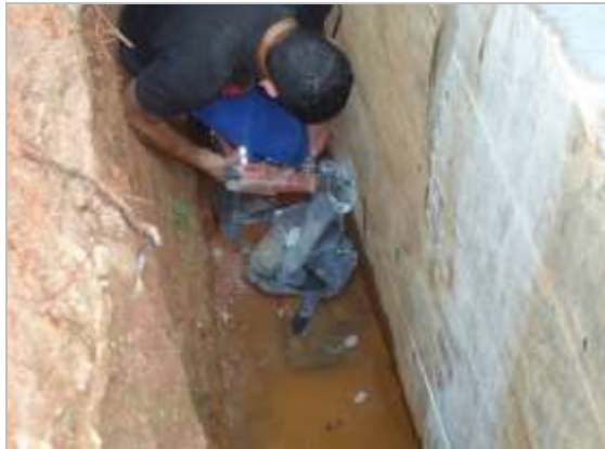
Figura 6: Extração de pó de concreto para ensaio laboratorial de teor de sulfatos.
