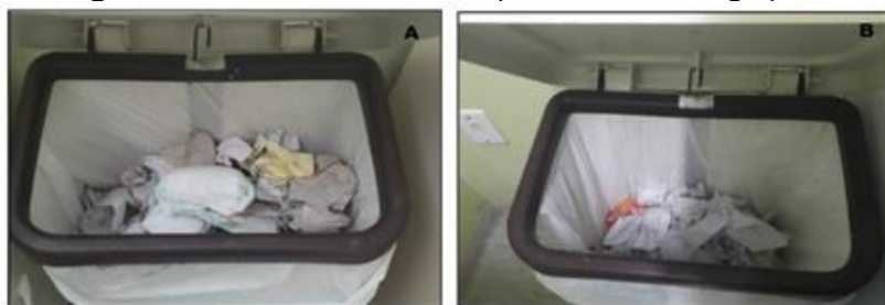
Figuras 09-A e 09-B - Coletores para resíduos do grupo A.
