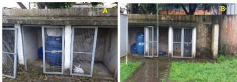
Figuras 21-A e 21-B - Ausência de identificação dos RSS no abrigo externo.
