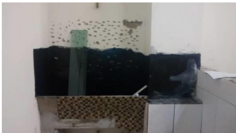
Figura 7: Vista da impermeabilização do tanque. Etapa em andamento de aulas com revestimentos em pastilhas. Fonte: Autores
