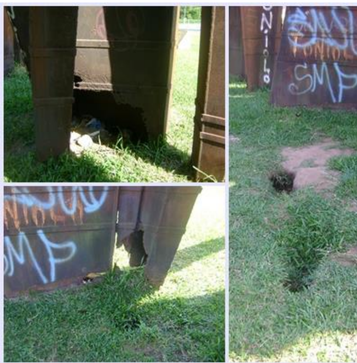
Figura 3: Danos ao Monumento dos Açorianos. Fonte: Autores.
