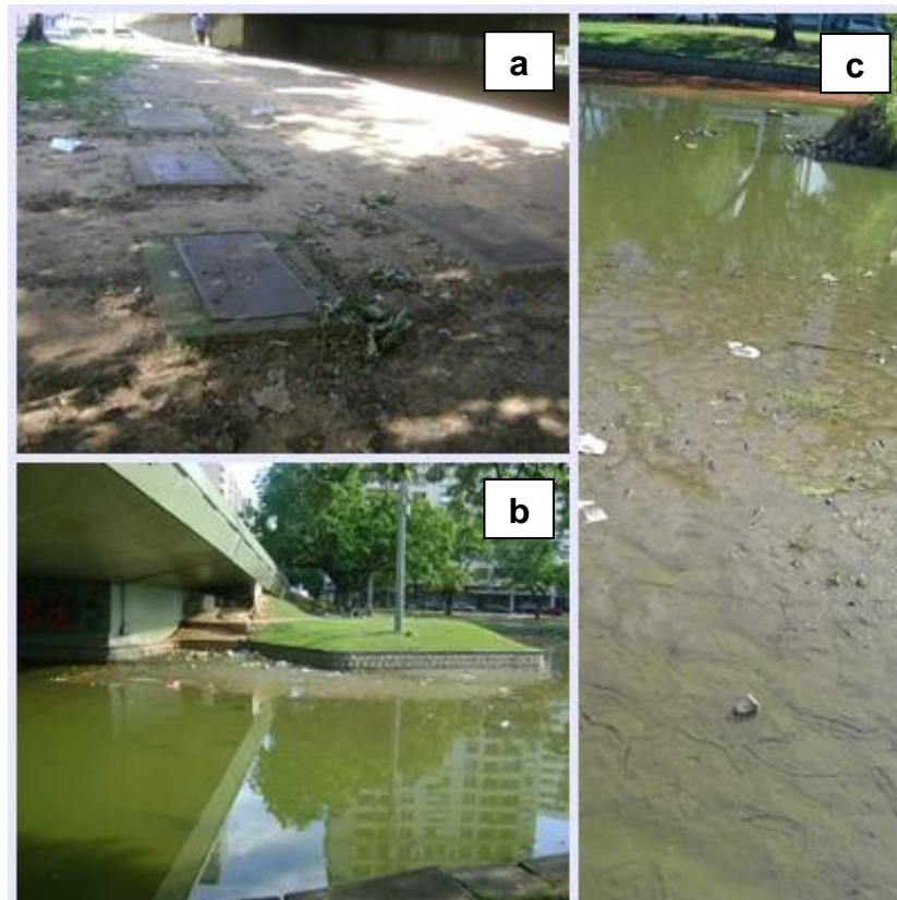
Figura 2: Galeria de rede de telefonia em desnível (a), moradores abaixo do viaduto (b) e assoreamento do lago (c). Fonte: Autores.
