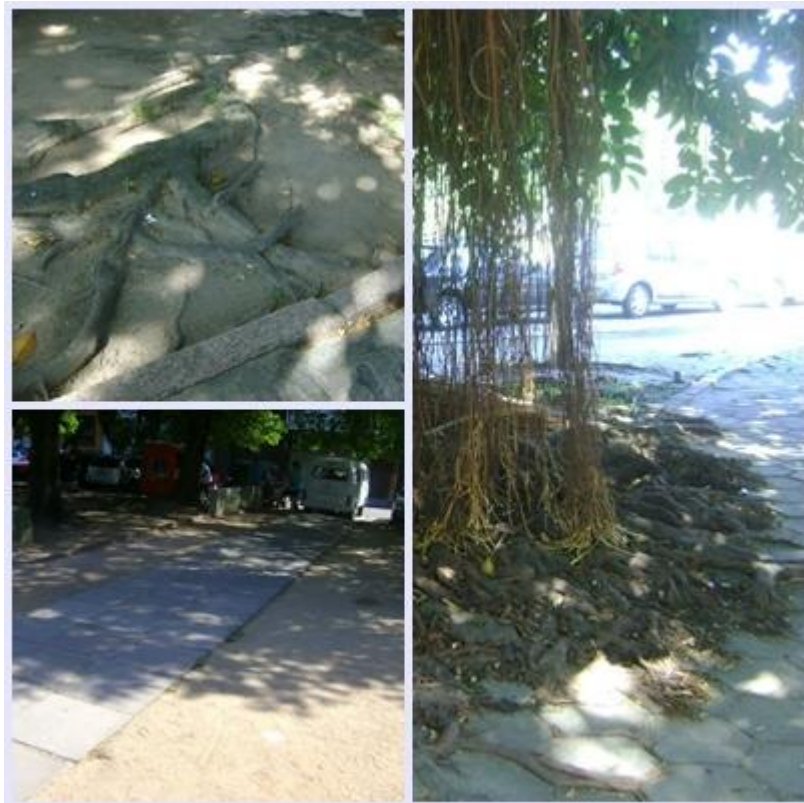
Figura 6: Piso irregular da Praça General Braga Pinheiro. Fonte: Autores.
